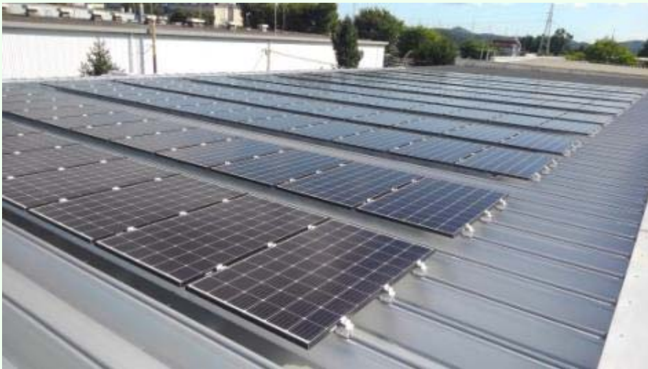
太陽光パネル
