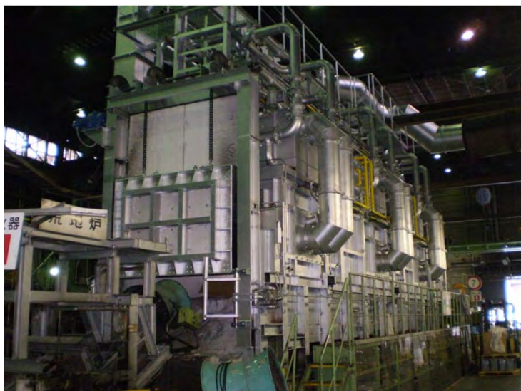
リジェネバーナーに変更した大型加熱炉
